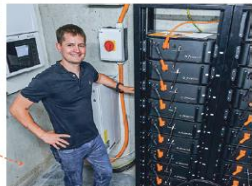
Davide Rivola, Projektleiter der Fachhochschule SUPSI, mit Quartierbatterie.
